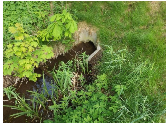
Abbildung 20: Rohrdurchlass unter der L 303 in der Ortschaft Blandow (Foto: Tschakert 2016)
