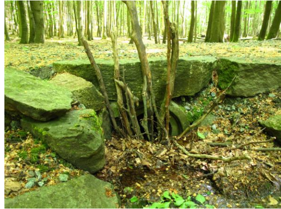
Abbildung 24: Rohrdurchlass am Kollicker Bach (Maßnahmen-Nr. 112_1). Mit Stöcken wird der Eintritt von Laub verhindert. (Foto: Thiele 2017)
