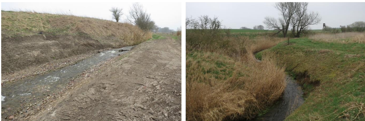
Abbildung 2: Sohlgleite zur Herstellung der ökologischen Durchgängigkeit kurz nach der Umsetzung (links) und tief eingeschnittenes Gewässer mit langen Böschungen und Böschungsabbrüchen im Oberlauf (rechts)
