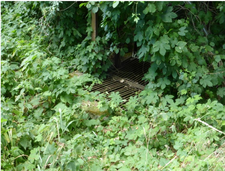
Abbildung 14: Absturz durch Gitterrost gesichert. Absturztiefe ca. 2 m. Foto: Christin Geisbauer, StALU VP (2018)
