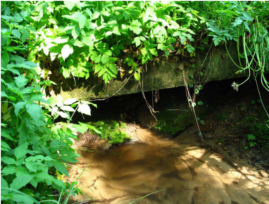
Abb. 6: Versandeter Rohrdurchlass am Tieschower Bach nordwestlich von Gummanz. Hier soll in der Umsetzungsphase des Managementplanes ein Kastendurchlass eingebaut werden. (Foto: Thiele 2017)
