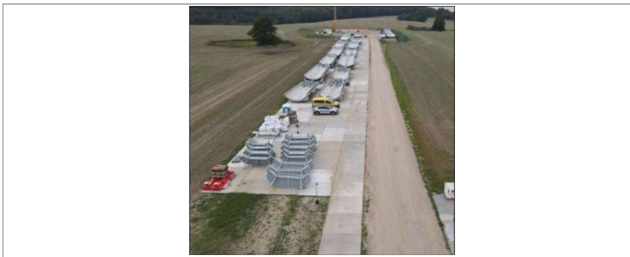
Abbildung 54 Bsp. Lagerung der Betonsektionen am Standort für den TCS179
