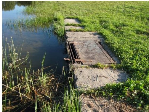
(2) Stau am Ablauf des Pelsiner Sees Vorher: Stau und Einlauf in die Verrohrung am Pelsiner See (2010)
