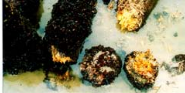
Durch Schiffsbohrwurmbefall abgebrochene Buhnenpfähle
